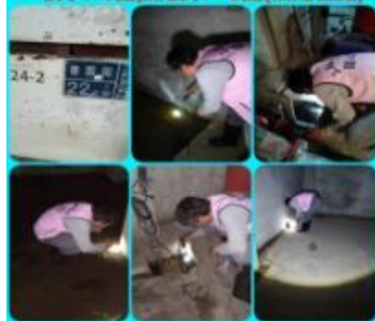
109.4/13下午複查安吉里地下室 積水:10處,無積水：3處(無陽性點)
